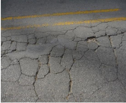
a) Fatigue Cracks
